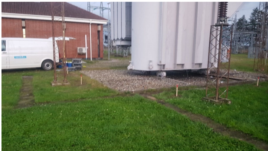
Figur 1 – Transformerfundamentet. Der er ikke observeret tegn på overfladeforurening med olie i jorden omkring fundamentet. Der er observeret olieforurening på skinnfundamenter under transformeren
